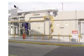
コージェネレーションシステム(加古川工場)
