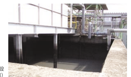
排水処理施設 (宮崎工場)
